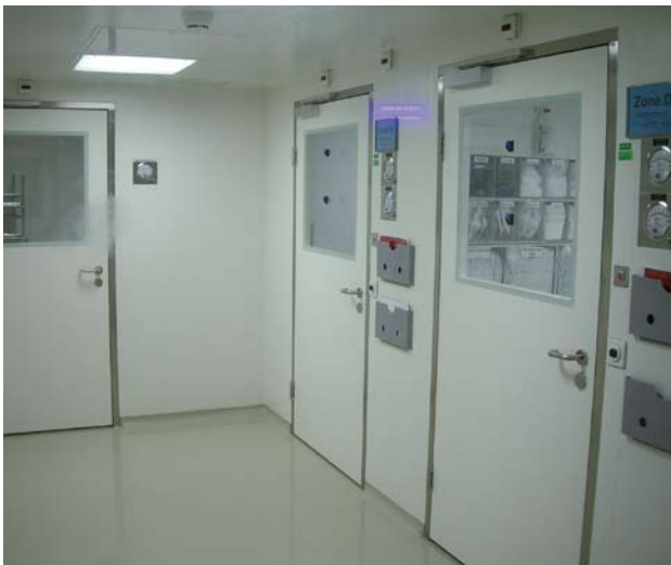
Reinraum-Vorschleuse. Einzelne Schleusen-Zugänge unter Reinraumbedingungen.
