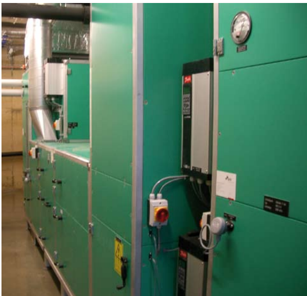
Zentrale Luftaufbereitung. Drehzahlregelung aufgrund der Druckverhältnisse.
