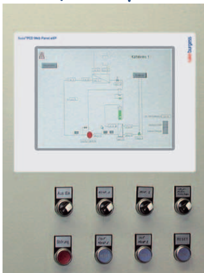
Steuerschrank mit Saia®Web-Panel in Touch Screen Technik
