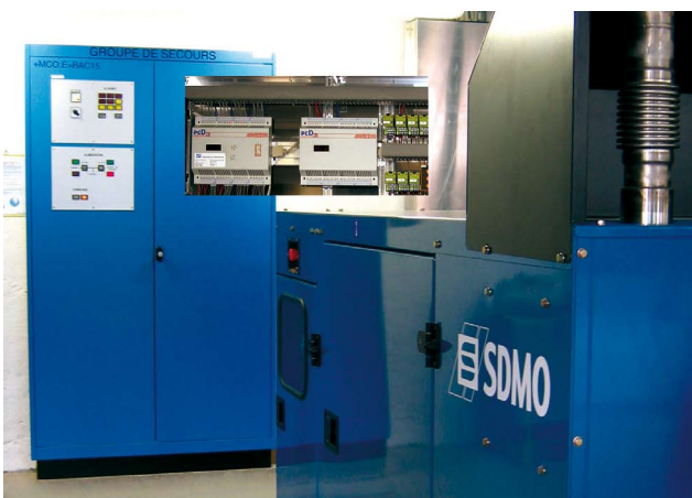
Steuerung für Notstromaggregat
