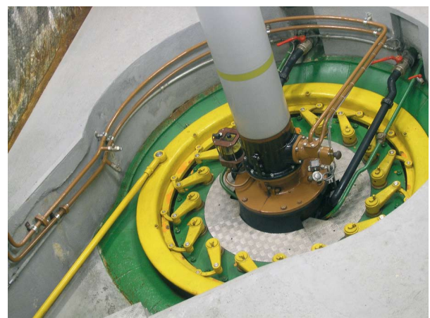
Francis-Turbine mit 800 kW Generator
