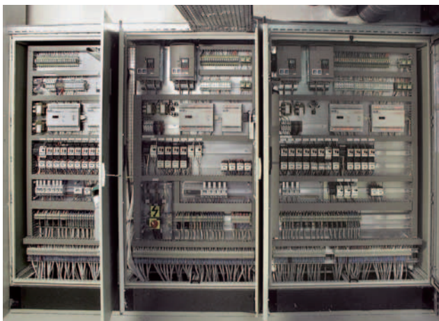
Schaltschränke mit den Unterstationen Saia®PCD2.M120 plus Erweiterungsgehäusen
