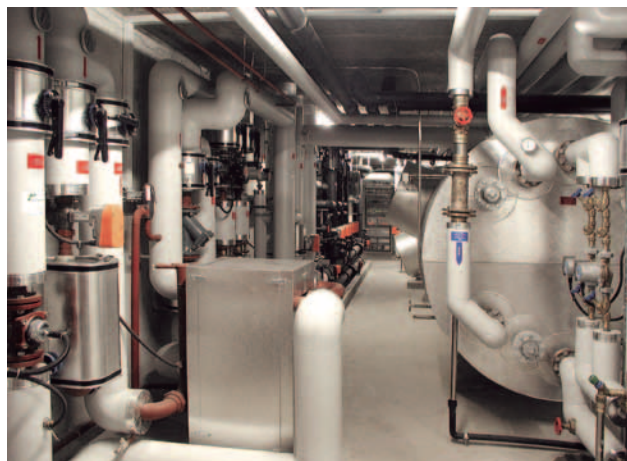
Warmwasserverteilung im Untergeschoss mit Belimo®-Stellantrieben
