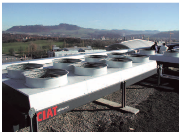
Kühlgeräte auf dem Hoteldach
