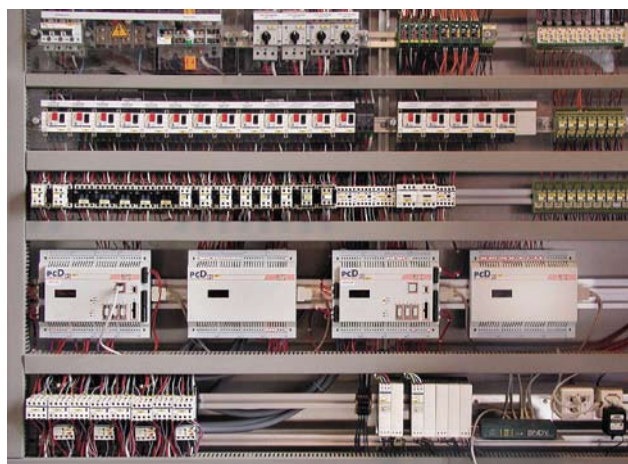
Schaltschrank HLK-A mit zwei Saia® PCD2.M170 mit Erweiterungsgehäusen für HLK-Steuerung der Verkaufsläden im Erdgeschoss und im ersten Untergeschoss
