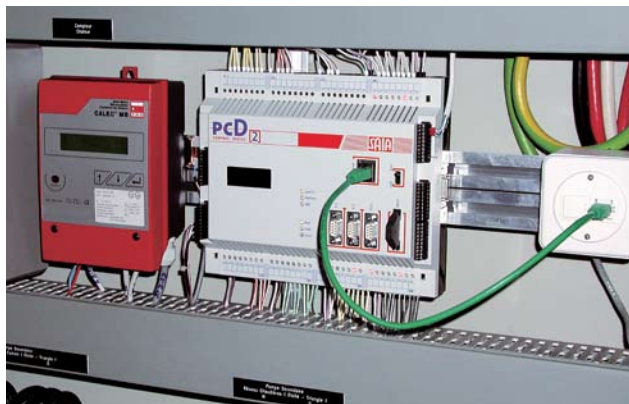
Unterstation im Hauptgebäude in Onex mit der Steuerung Saia®PCD2.M170, angeschlossen ans Ethernet-Netzwerk
