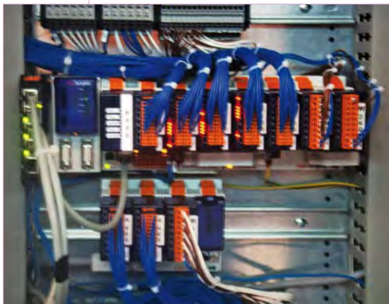
Quadro elettrico della stazione di pompaggio con controllori Saia®PCD3
