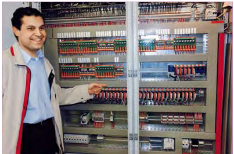
Il responsabile del progetto del cliente, di ottimo umore, davanti a un quadro elettrico con alcuni controllori Saia®PCD3.M5.
